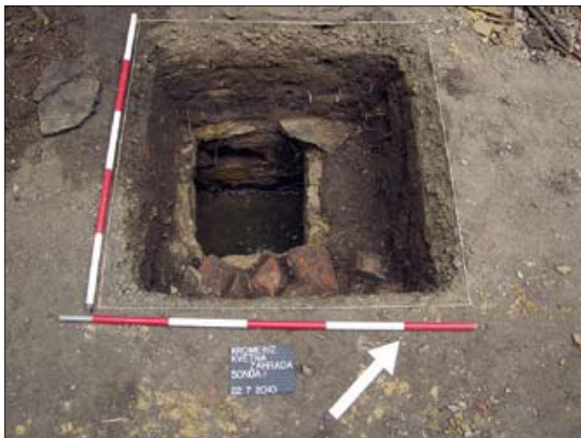
Obr. 17: Příčinou vzniku poruchy v cestě mezi Jahodovými kopečky v kroměřížské Kočetné zahradě bylo prolomení pískovcové desky překrývající reovizní otvor. (Foto J. Janál)
