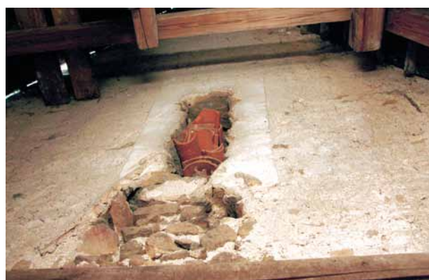
Obr. 6. Nezamyslice, kostel Nanebevzetí Panny Marie. Otisk vrcholu sedlové střechy staršího kněžiště pod větracím okénkem ve štítu nad vítězným obloukem. Pohled od východu. (Foto R. Lavička, 2015)
