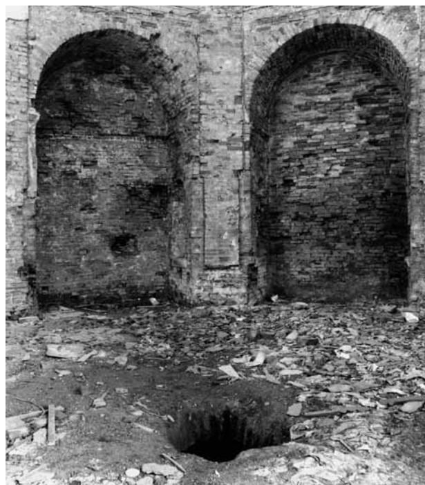
Obr. 8. Ostrov, kaple sv. Anny. Interiér. Pohled v přízemí. Staré omítky vzaly za své z důvodu zemní vlhkosti. (Fotoarchiv Národního památkového ústavu, ú. o. p. v Plzni, foto J. Gryc, 1990)
