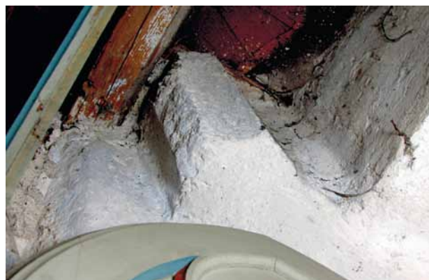
Obr. 5. Nezamyslice, kostel Nanebevzetí Panny Marie. Torzo žebra gotické klenby v severozápadním koutu kněžiště při vstupu na kazatelnu. (Foto R. Lavička, 2015)
